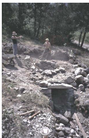
Construction du 1 er four à chaux en 2003 par J-P et Y. FINE
